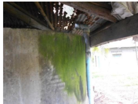
(d) Broken water supply at the noodle factory
